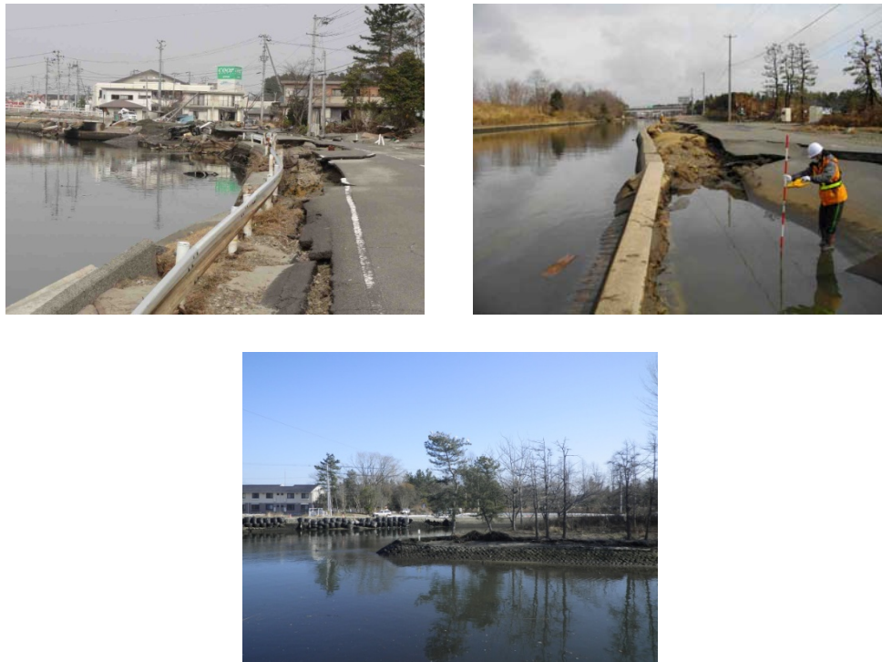
図4-9 貞山運河〔御舟入堀（砂押貞山運河）〕の被災状況
