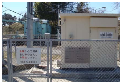
川崎水位観測局
