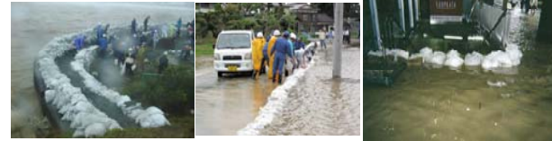
大淀川での水防活動の状況 雄物川沿川での水防活動状況 地下街への入り口に土嚢設置状況 (福岡市博多区)
