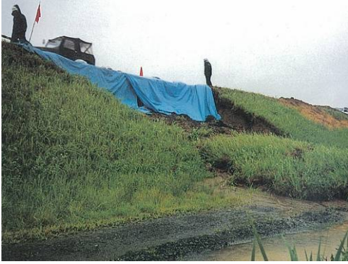
写真 2-23 堤防崩れの状況
