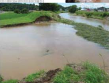
荒川 破堤 (村田町小泉地内)
