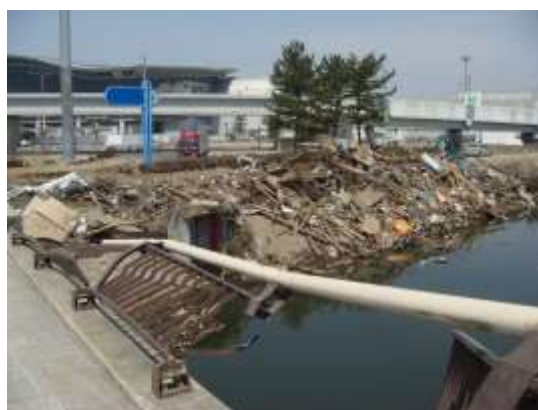
被災した橋梁 (南貞山運河)
