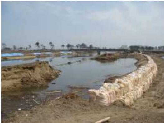
被災した堤防（五間堀川）
