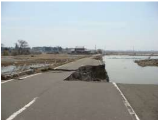
被災した橋梁（五間堀川）
