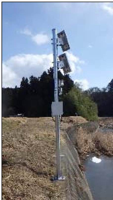
監視カメラ 設置状況（七北田川）
