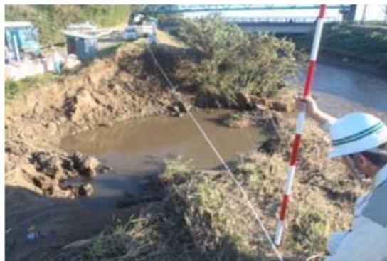
砂押川の破堤状況
