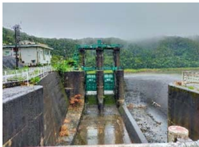
常用洪水吐の様子
