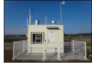
広域モニタリングステーション
