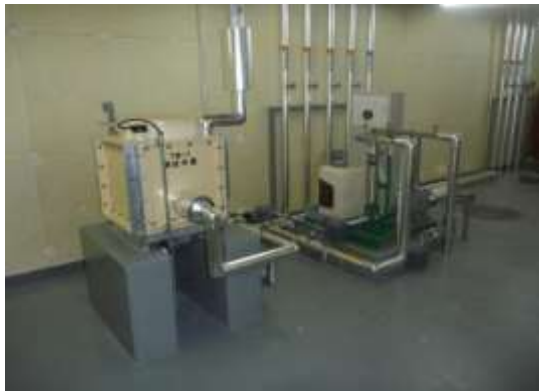
写真 5.2 雨水利用の取組事例 (宮城県保健環境センター)
