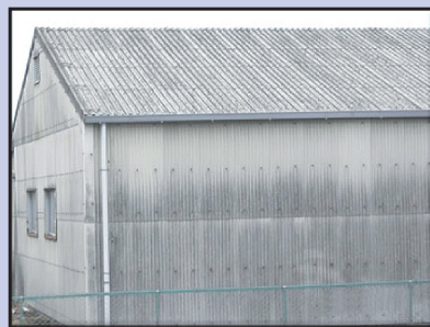
石綿含有波板スレート板
