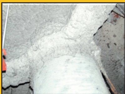
吹付け石綿 (鉄骨耐火被覆材)
