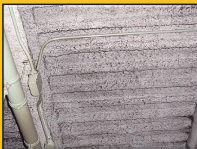
石綿含有吹付けロックウール (天井断熱材)
