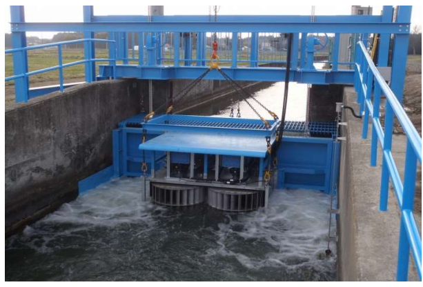
設置例：内川小水力発電所（大崎市）
