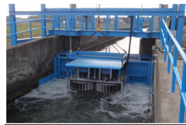
モデル実績：内川小水力発電所（大崎市）
