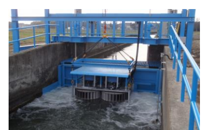
モデル実績：内川小水力発電所（大崎市）
