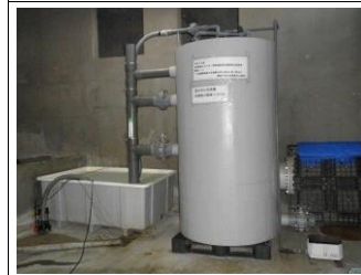
排水浄化処理槽
