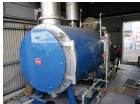
▲還流ボイラー
