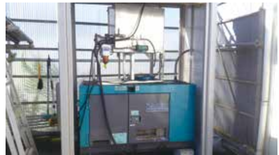
▲ SVO 燃料発電機 (上部加温装置・ろ過フィルター)
