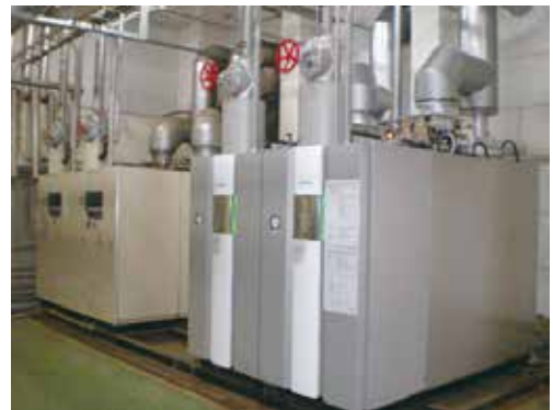
▲ H29：手前側2台のボイラーを更新
