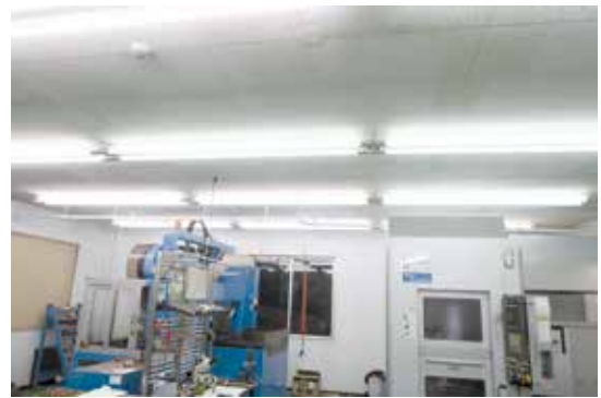
▲蛍光灯照明器具（更新前）
