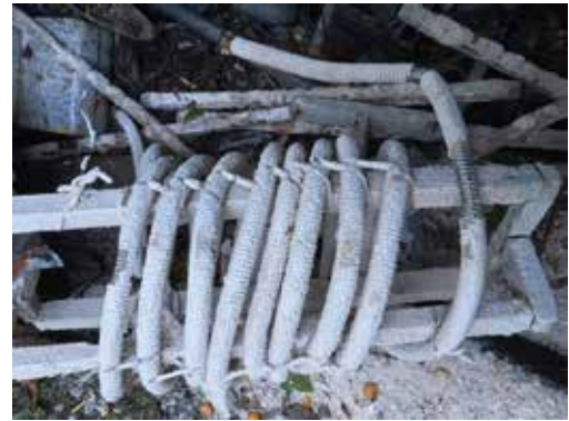
▲スケールが付着した熱交換コイル
