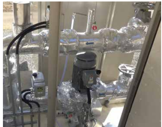
▲発電設備 内部
