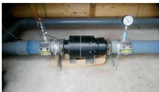
▲デジタル圧力計で水量をデータ化 遠隔監視データ、自動過水防止、自動落葉除去、バルブの自動開閉等を行う。
