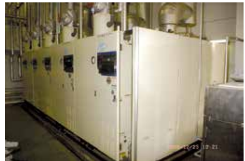
▲旧型ボイラー
