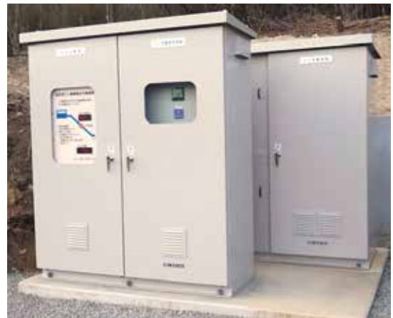
▲ニッ森水力発電所 全景
