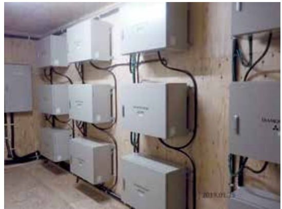
▲パワーコンディショナ設置状況
