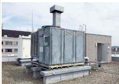
▲吸収式冷凍機（更新前）
