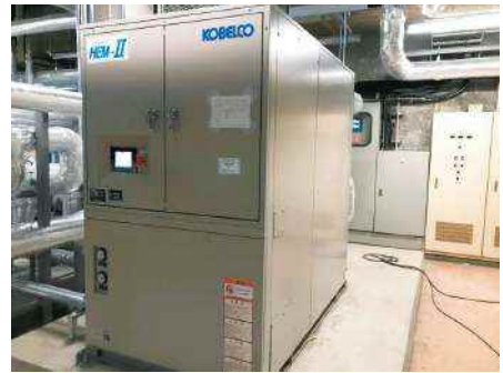
▲地中熱ヒートポンプ
