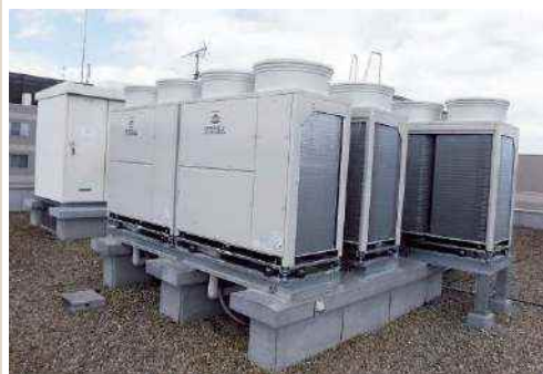
▲1, 2, 3階系統ヒートポンプ（更新後） エアコンの室外機。既存基礎を利用。
