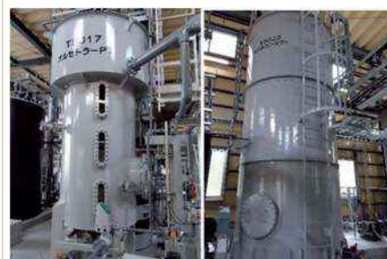
▲高速凝集沈殿槽＋流動床式生物処理
