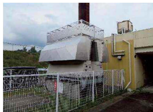
▲更新後の空冷式ヒートポンプチラー
