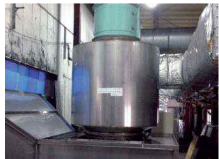
▲導入設備 2 塗装排気処理装置
