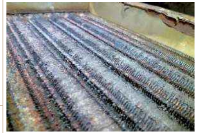
▲ガスクーラーの腐食閉塞
