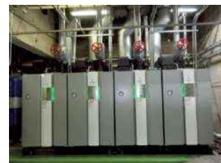
▲蒸気ボイラー（更新後）
