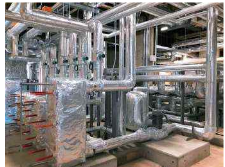
▲システム関連設備
