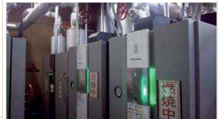
▲手前 2 台 新規導入ガス炊きボイラー
