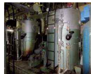
▲蒸気ボイラー（更新前）
