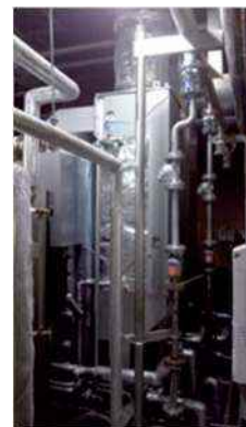
▲ガスボイラー（エコノマイザ）
