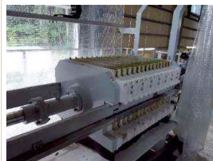
▲全自動汚泥脱水機
