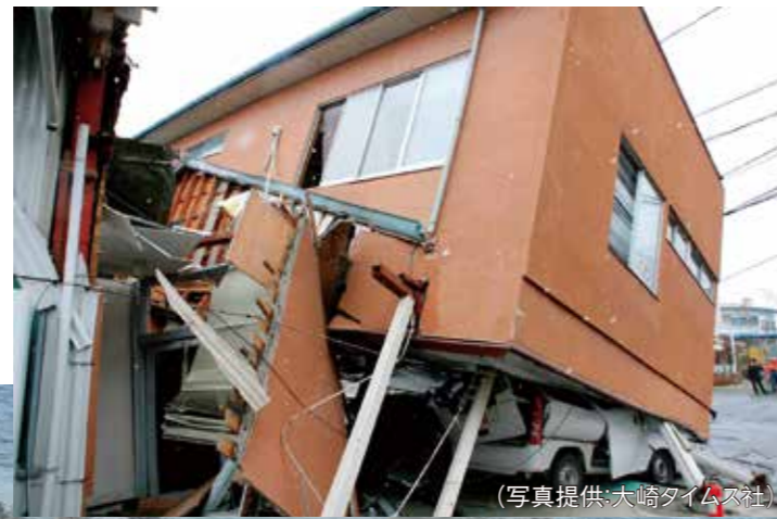
建物の倒壊(大崎市)
