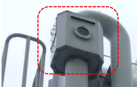
交換前の避圧弁 (収納箱外観)
