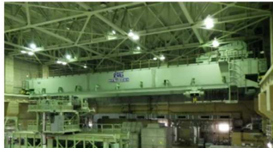
天井クレーン全景（写真）
