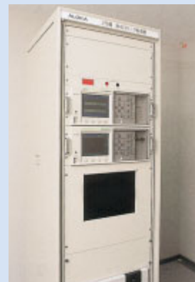
放水口モニター監視盤(2号機)
