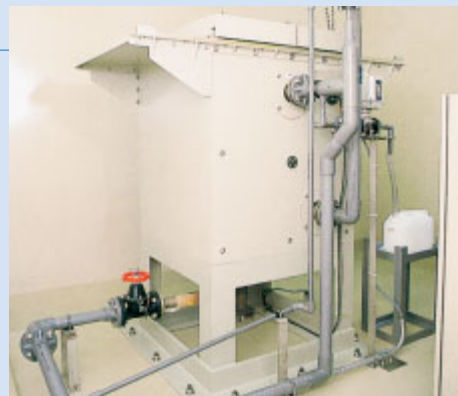
放水口モニター(2号機)
