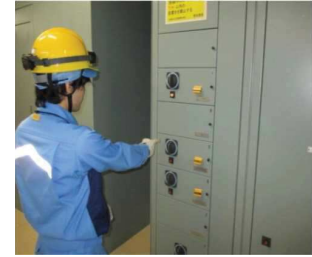
不要負荷切離し(作業イメージ) (中央制御室外遮断器)
