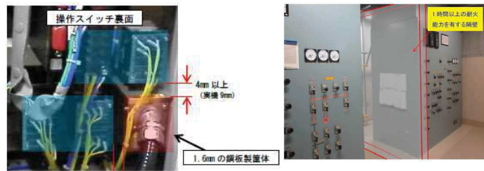
中央制御室制御盤内対策
