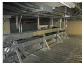
区分Ⅱケーブル処理室
