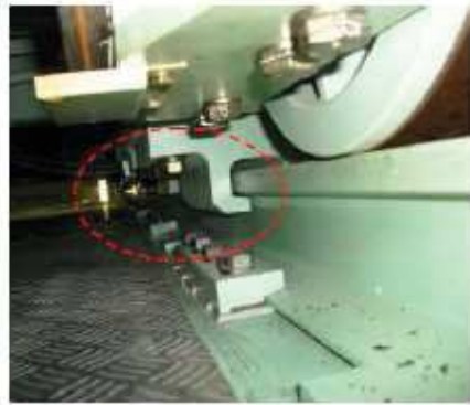
燃料交換機（トロリ）転倒防止装置
