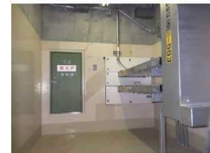
区分Ⅲケーブル処理室
