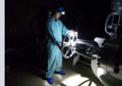
ヘッドライトを使用した状態での弁の開閉操作
