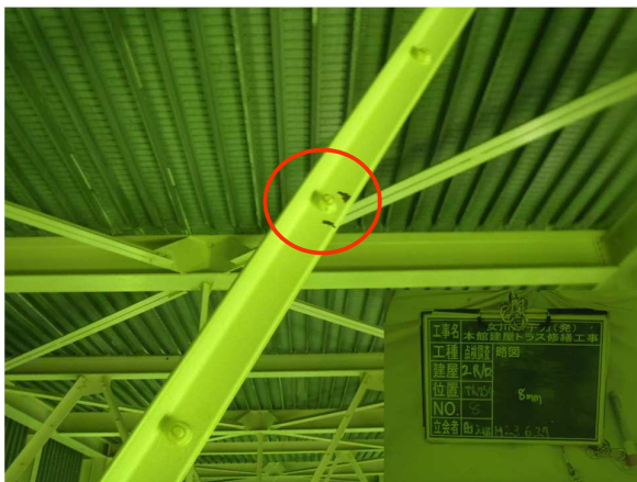
サブトラス(構造部材) 斜材 8mm変形
