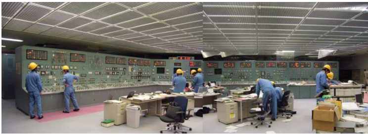
震災時の中央制御室の様子
