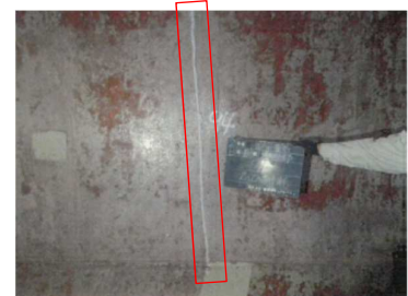
白線は、ひび割れ上にマーキングしたもの
