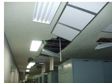
天井の被害例(3.11地震時中央制御室)
