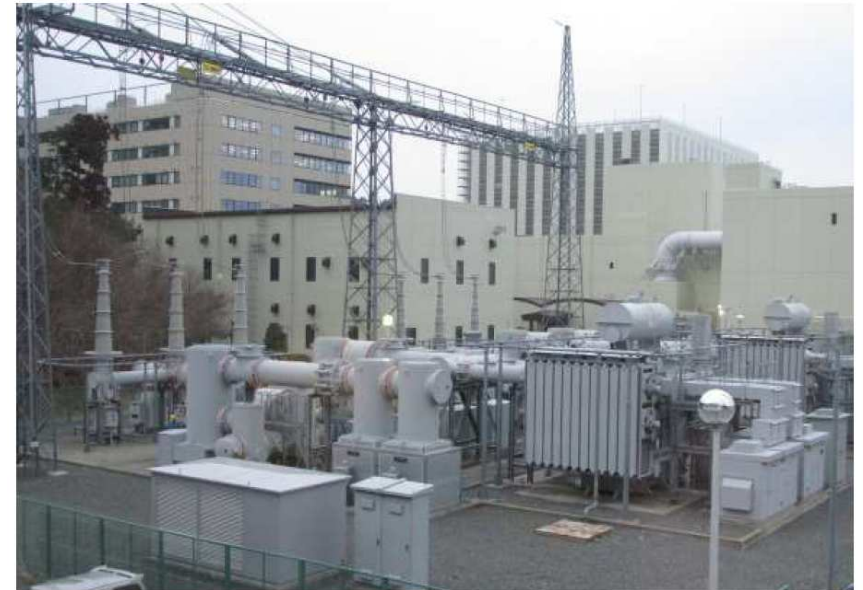
開閉所設備外観
