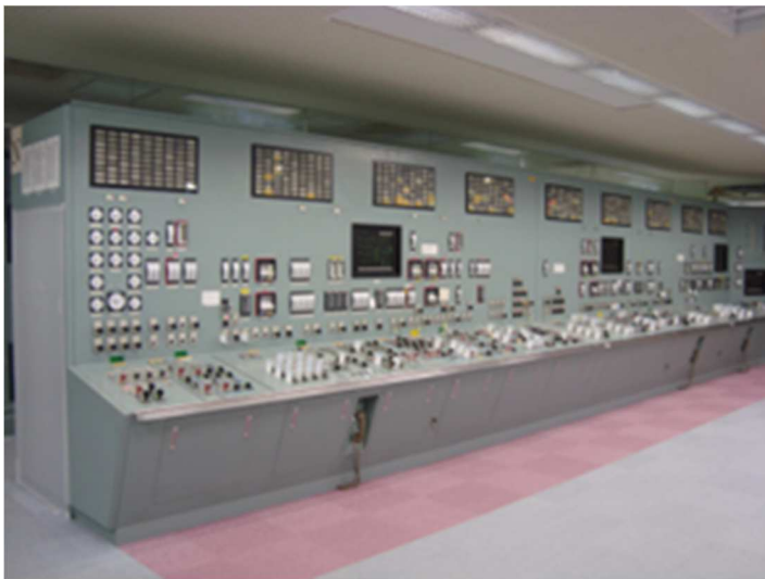
女川2号中央制御室
